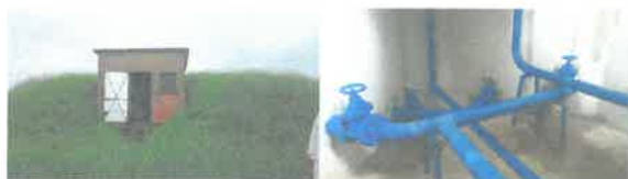
Chambre de vannes
