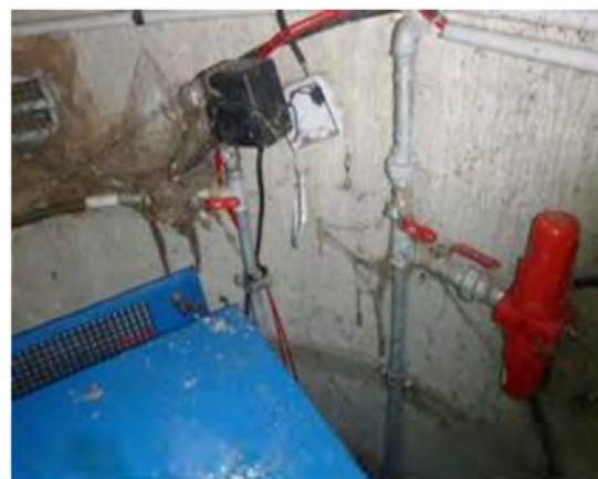
Compresseur système Soterkenos Mauvais raccordement électrique
