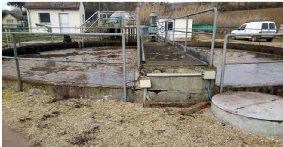
Bassin aération - fissure -
