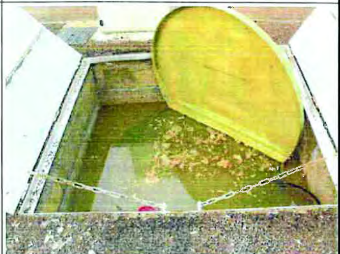
PR 8 : Ø200 à ...m – PR en charge Rue Porte d'en Haut (Chevannes)
