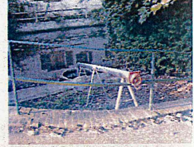
Puisard aménagé dans la rivière avec ligne d'aspiration
