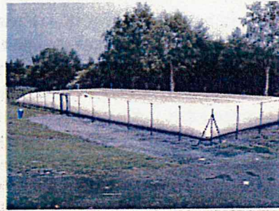
Citerne souple avec poteau d'aspiration
