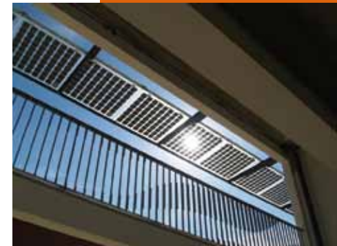
> Capteurs photovoltaïques en brise-soleil
