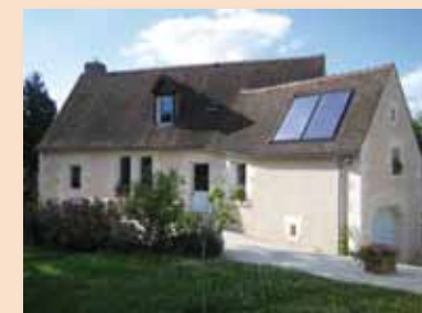
> Capteurs intégrés en toiture (CESI)
