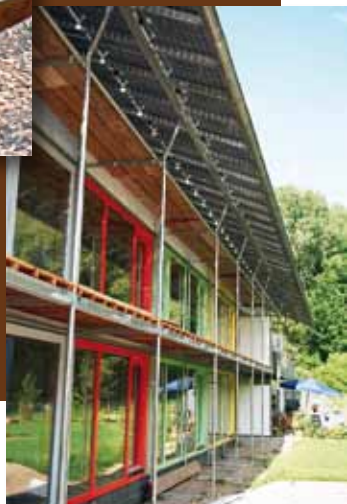
> Photovoltaïque en toiture avec auvent
