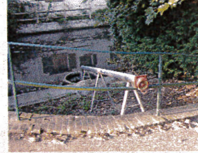
Puisard aménagé dans la rivière avec ligne d'aspiration
