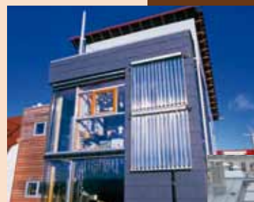
> Capteurs sous vide en façade
