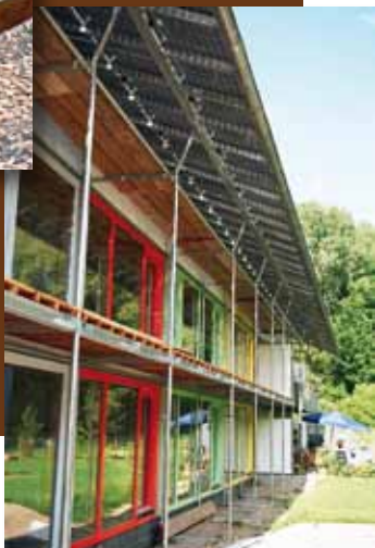
> Photovoltaïque en toiture avec auvent
