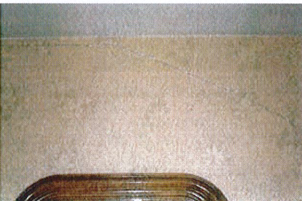
Fissuration intérieure, tapisserie déchirée - Maison André.
