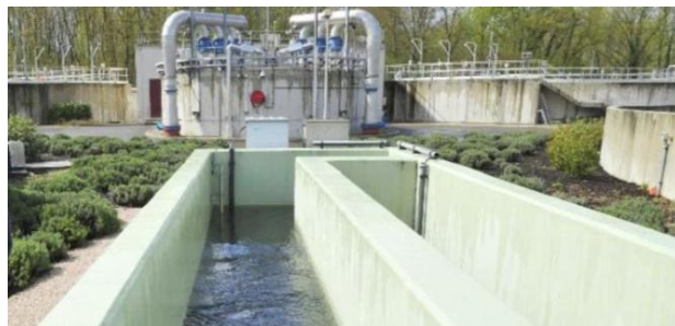
Station d'épuration d'Appoigny
